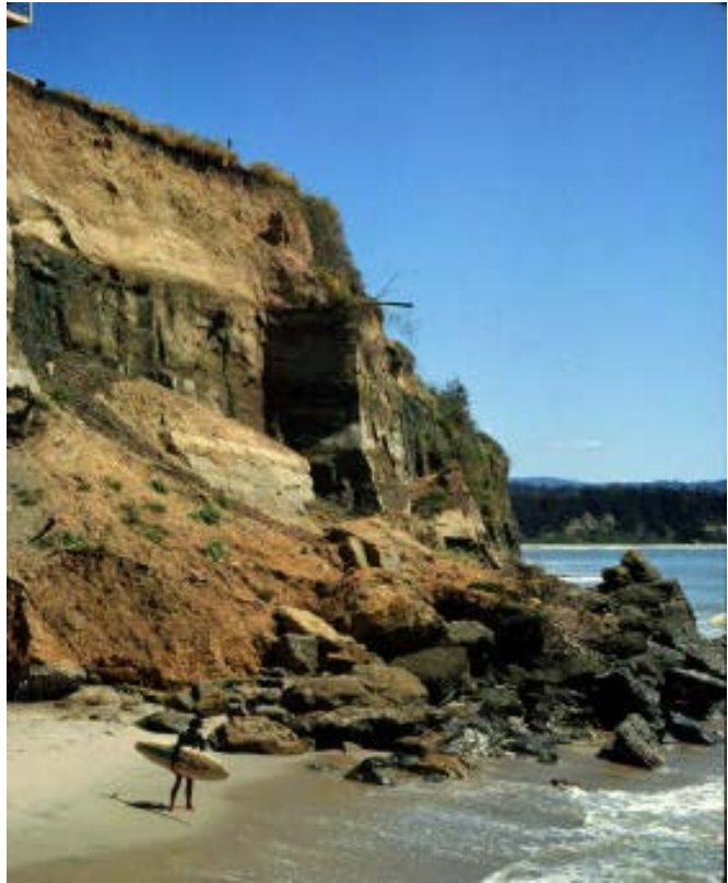
Figure 11 - Episodic coastal bluff failure in Capitola
